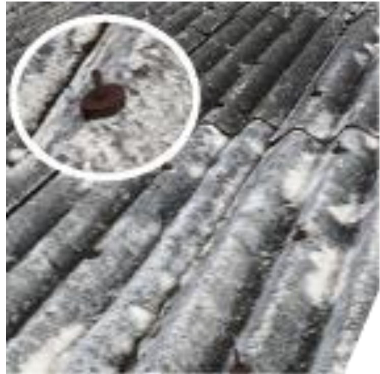
ボルト周りの劣化（コーキング箇所の劣化）
